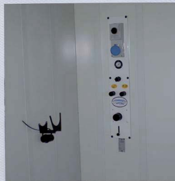
IMPIANTI ASPIRAZIONE POLVERI
