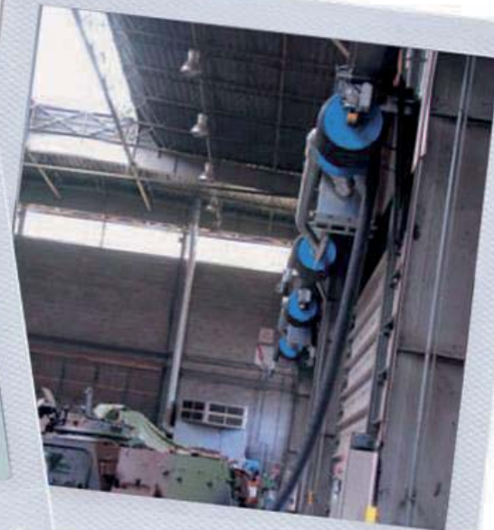
IMPIANTI FUMI DI SCARICO
