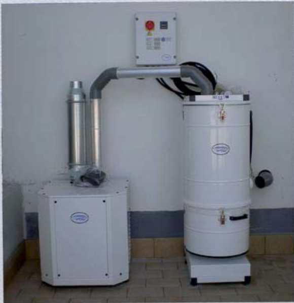
IMPIANTI ARIA COMPRESSA
