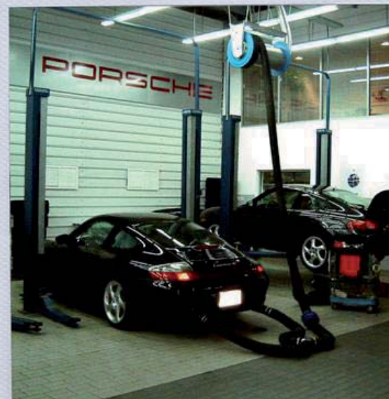
IMPIANTI FUMI DI SCARICO
