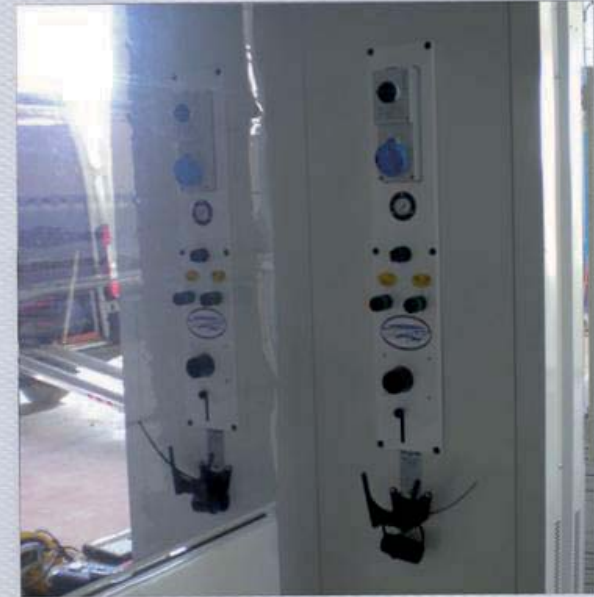
IMPIANTI ASPIRAZIONE POLVERI
