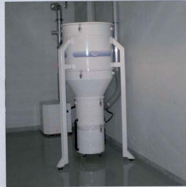
IMPIANTI ASPIRAZIONE POLVERI
