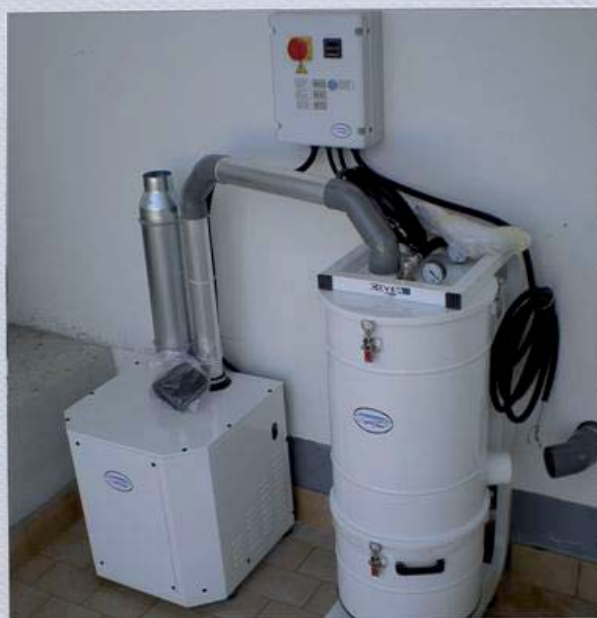
IMPIANTI ASPIRAZIONE POLVERI
