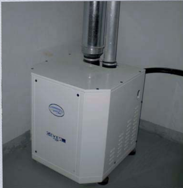
IMPIANTI ASPIRAZIONE POLVERI
